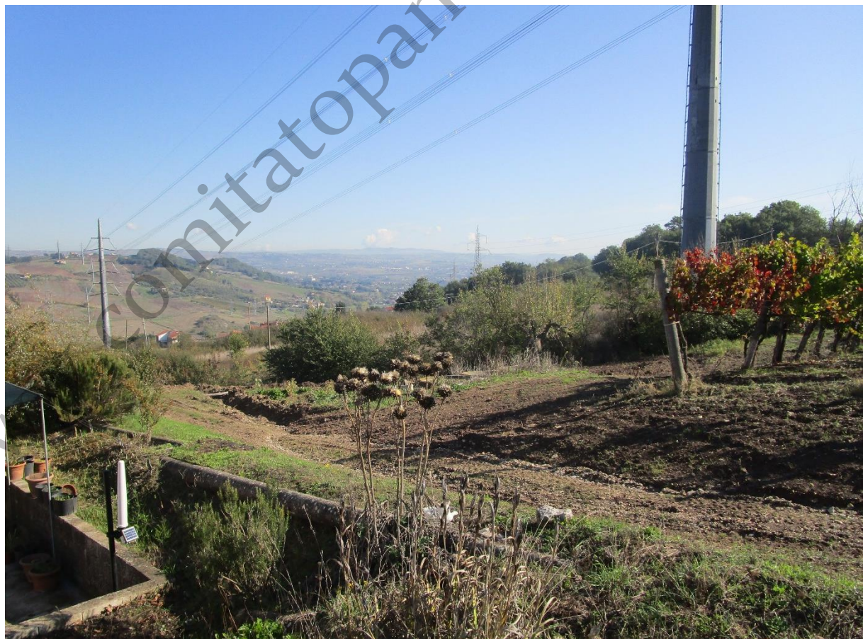
Figura 4 Immagine della centralina installata in contrada Pino
